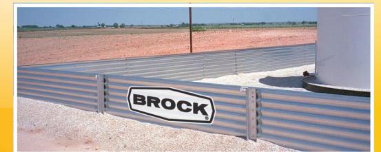
Sistema de contención de aceite
