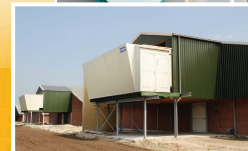
Sistemas de limpieza y filtrado de aire
